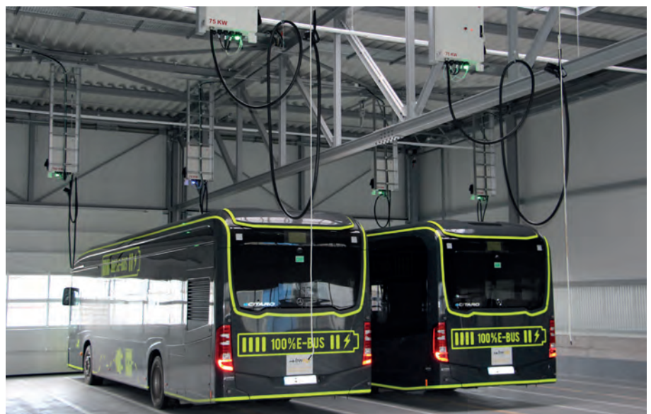
Busladestationen wie die von Omexom im Reutlinger Busdepot errichtete benötigen eine Leistung von bis zu 150 kW
